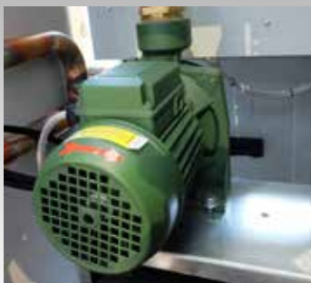
Pompa di circolazione - Circulating pump
