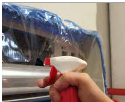
PULIZIA BATTERIA TRAMITE FORO INSERIMENTO SPRUZZINO
