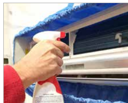
PULIZIA BATTERIA SENZA TELO DI PROTEZIONE
